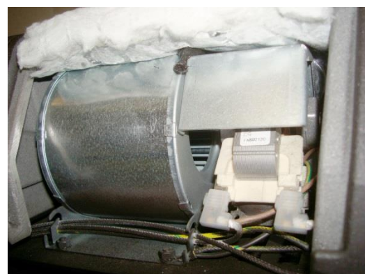
Figura nº26 - Acceso a los ventiladores
